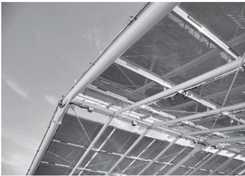
Imagen 2: Paneles de la Terraza Solar que poseen un sistema fotovoltaico conectado a red con módulos fotovoltaicos semitransparentes de integración arquitectónica.
